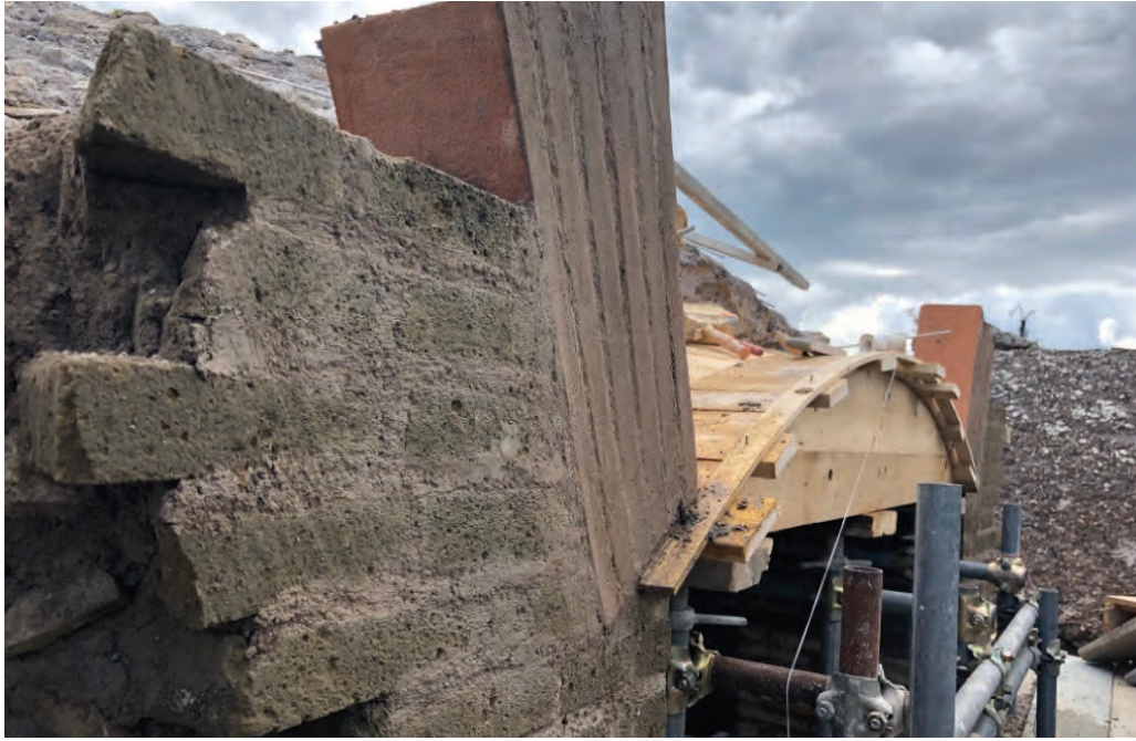
Sala Ottagona - esterno Ricostruzione degli archi secondo la geometria originaria di progetto: posa dei bipedali.
